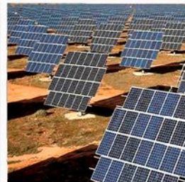
Солнечная электростанция 48 г (CO 2 )/КВт в час
